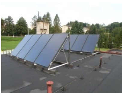
Solární ohřev budovy SK
