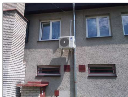
Klimatizace v SK
