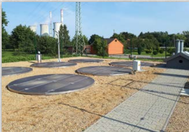
^ Čistírna odpadních vod pro Šlog a základní školu.
