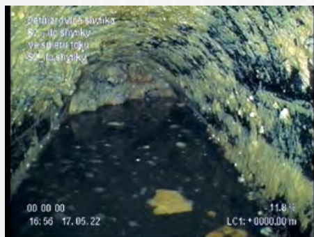
Částečně ucpané potrubí tukem a olejem.
