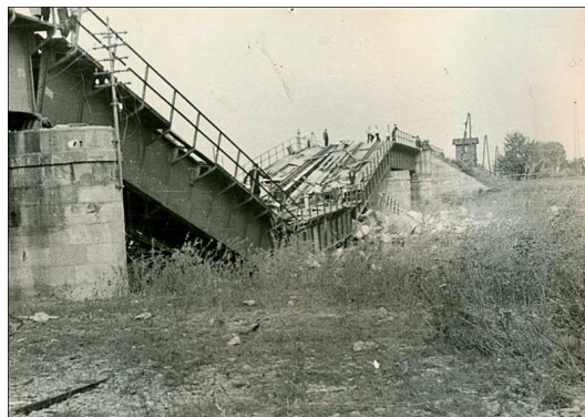
Zničený železniční most
