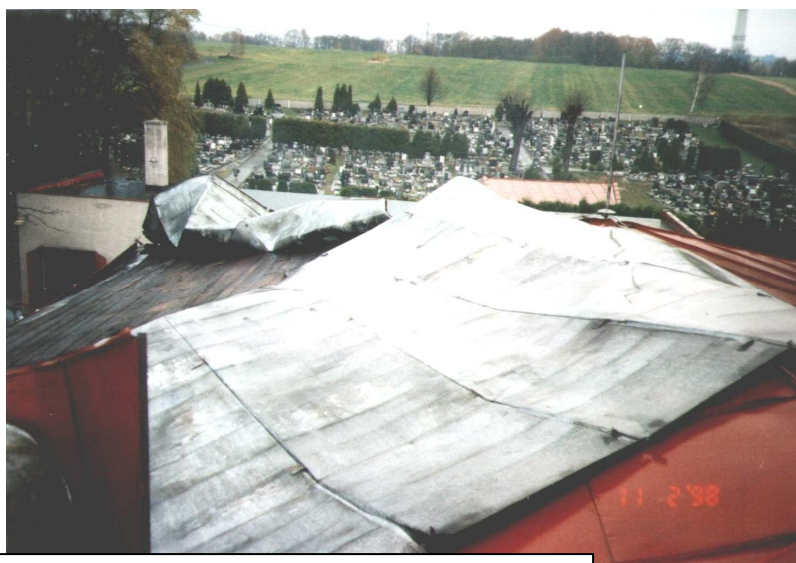
Poškozená střecha na budově čp. 22, kterou strhla vichřice ve večerních hodinách dne 1.11.1998
